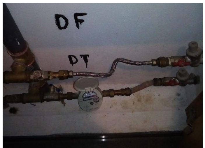
Figura 11: Exemplo de uma ligação direta fornecida pela empresa Águas de Gaia, EM, S.A.
