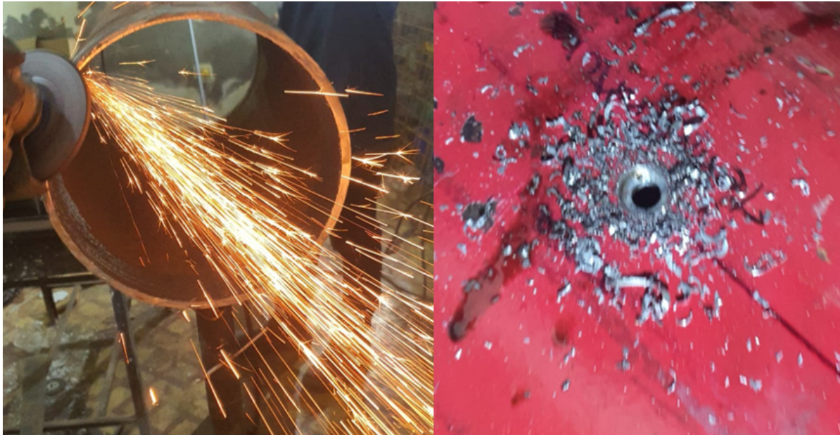
Figura 74. Preparación de cuerpo de caldera.
