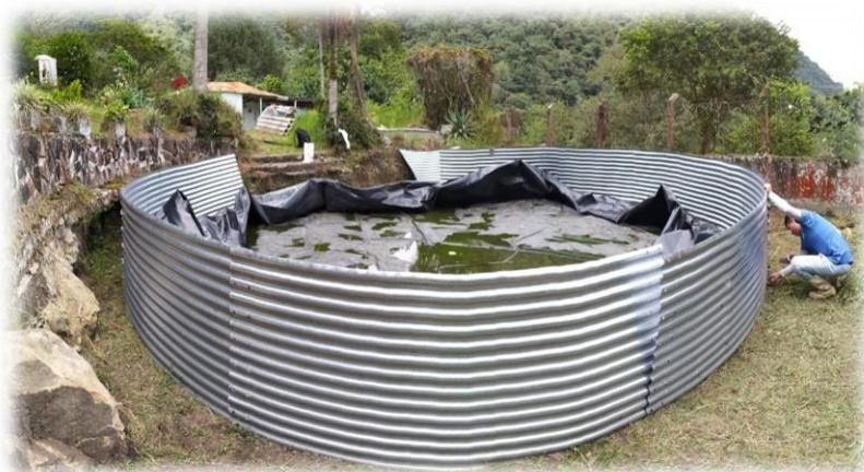
Tanque de almacenamiento de agua
