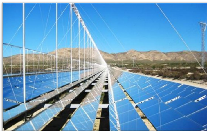
Figura 1.4.2.3.1: Planta Solar con espejos de Fresnel. Puerto Errado, España.
