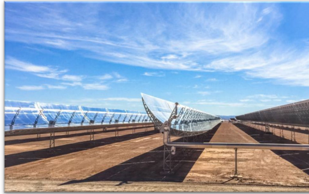
Figura 1.4.2.2.1: Planta Solar PTC; Noor Ouarzazate I. Uarzazate, Marruecos
