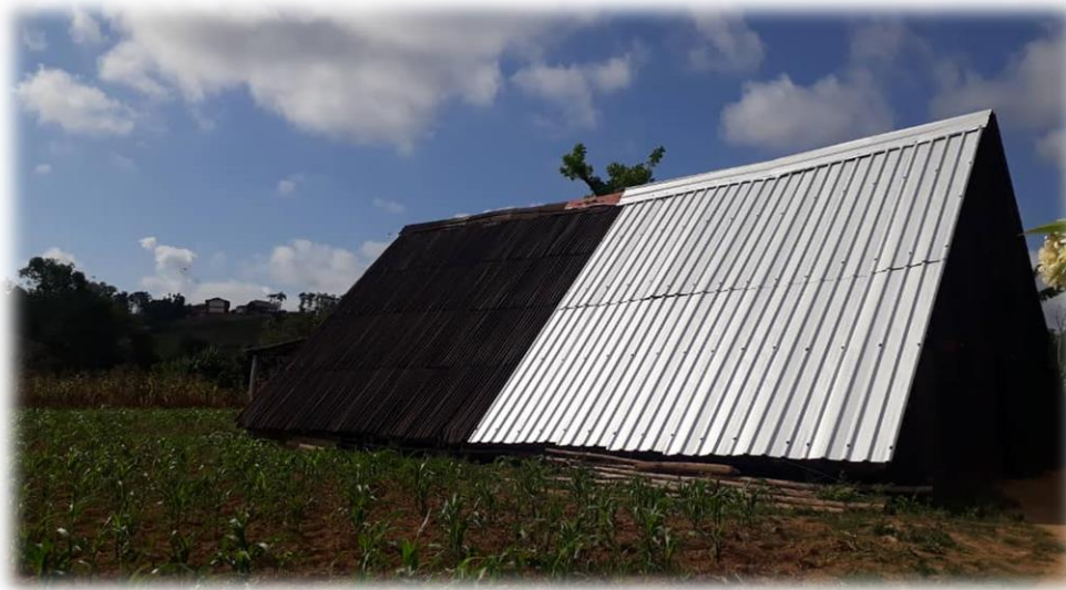
Figura 4: Casa de cura de tabaco en la ZRE que atenta contra el valor excepcional del sitio patrimonial.
