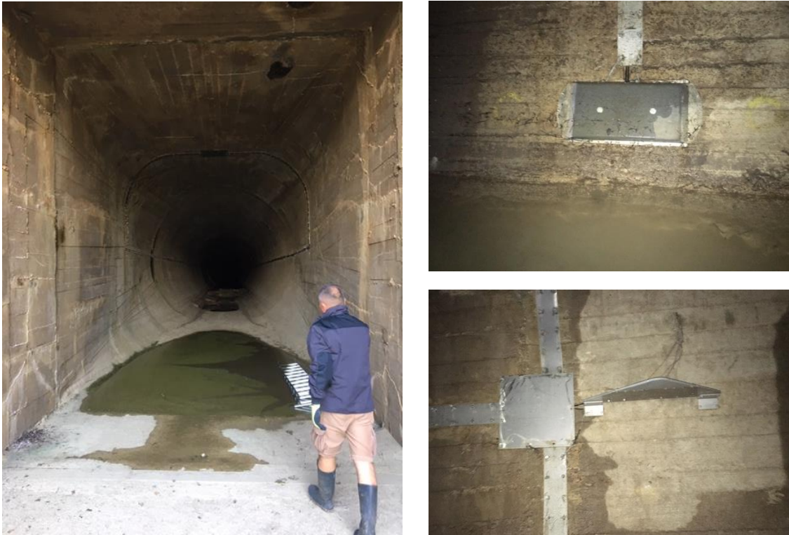
Slika 4. Merni sistemi u okviru derivacionog tunela Dabarsko polje – Fatničko polje: Izlazno/Ulazna građevina u Fatničkom Polju (Levo); Veliki ravni EM senzor u okviru osnovnog mernog sistema (Desno, gore); EM senzor „Ajkulino krilo“ u okviru kontrolnog mernog sistema (Desno, dole)
