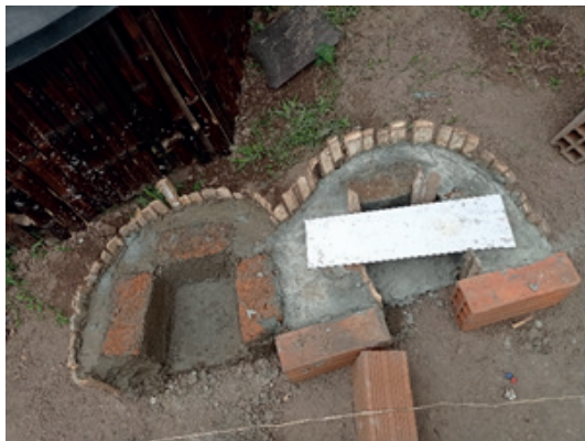
Figura 38. Bases Soportes de los Filtros
