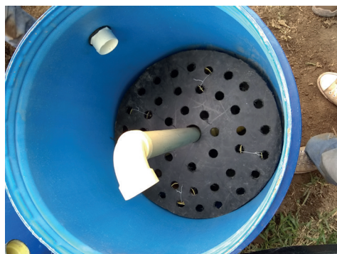
Figura 20 a. Filtro Mecánico
