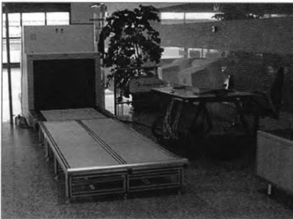
Sistemas de inspección de equipajes y pasajeros. Fuente: Autoridad Portuaria Bahía de Algeciras.
