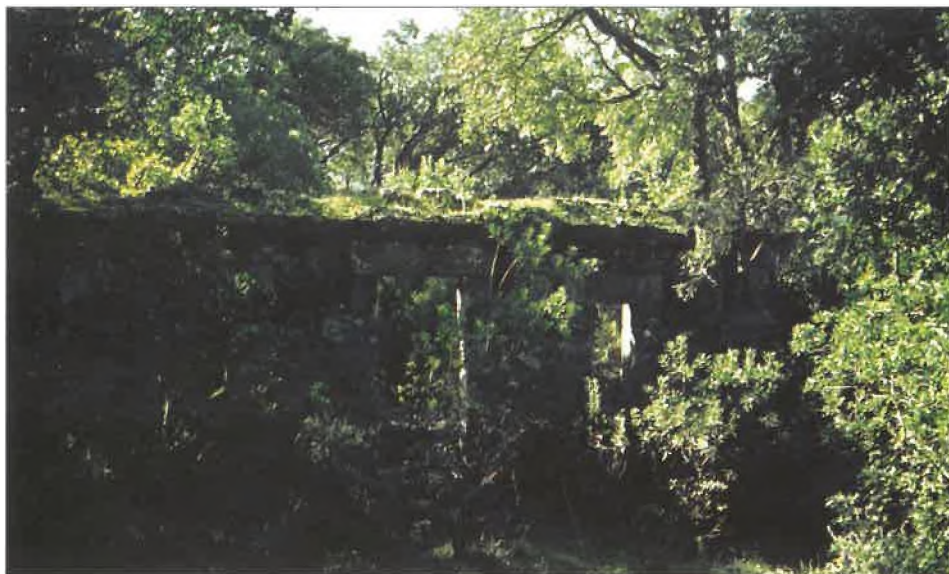
Fig. 48. La ermita cuadrangular “de los cuatro pilares”, en la ladera de levante. Las de este modelo fueron construidas en 1757 y 1760 y posteriormente reestructuradas.
