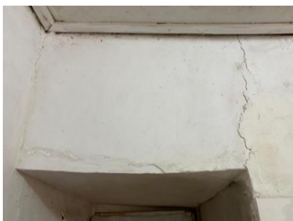
Fotografía 4. Pandeo de la losa y grieta vertical de 2 mm de espesor
