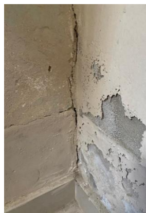
Fotografía 3. Presencia de humedad en la parte inferior del muro
