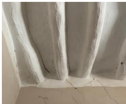
Fotografía 1. Grietas de 4mm de espesor en viguetas, losa y muro
