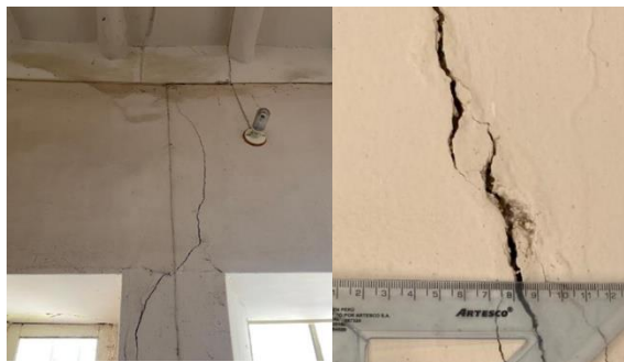
Fotografía 2. Grietas de 4mm de espesor en muros
