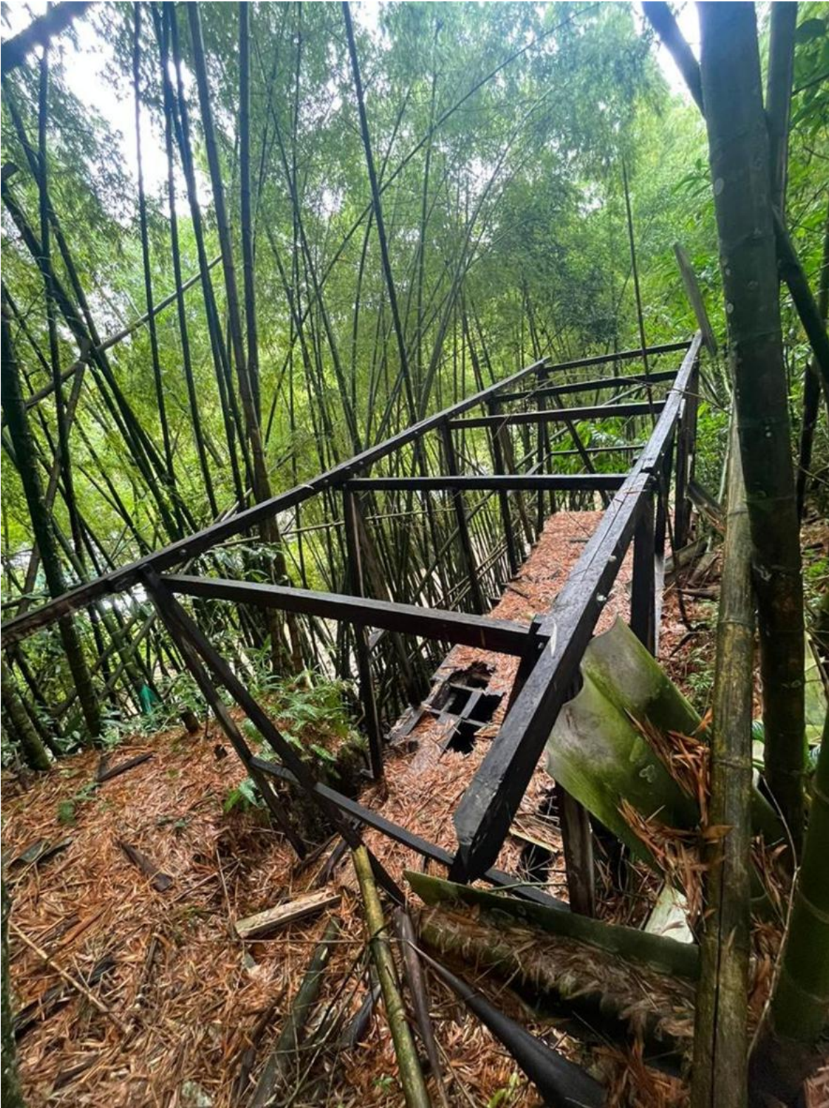
Fotografía 11. Estructura en madera que funcionaba como posible mirador. Fuente: Propia, 2022.
