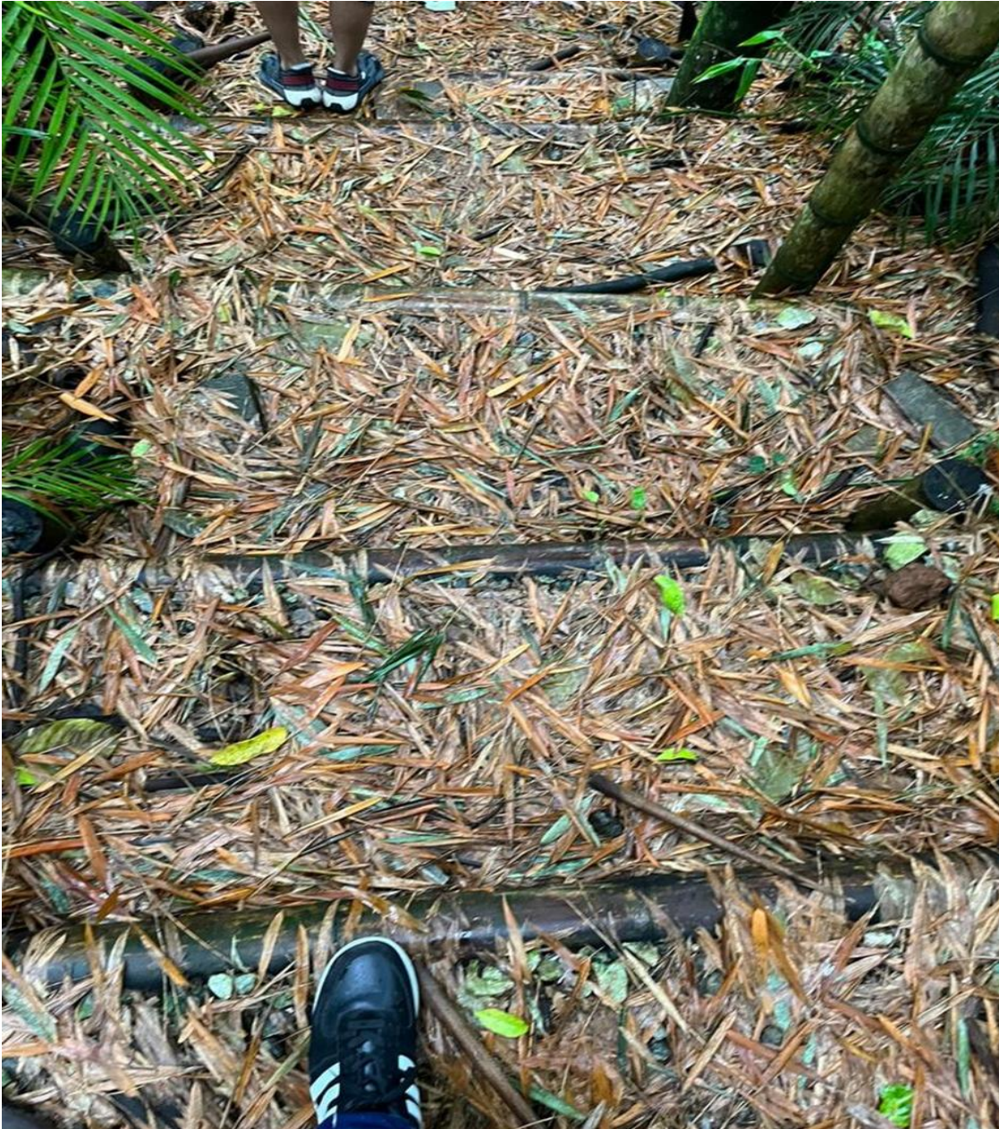
Fotografía 8. Escaleras en guadua, que denotan a su vez el tiempo en desuso y poco mantenimiento del sendero por la cantidad de material vegetal sobre ellas. Fuente: Propia, 2022.
