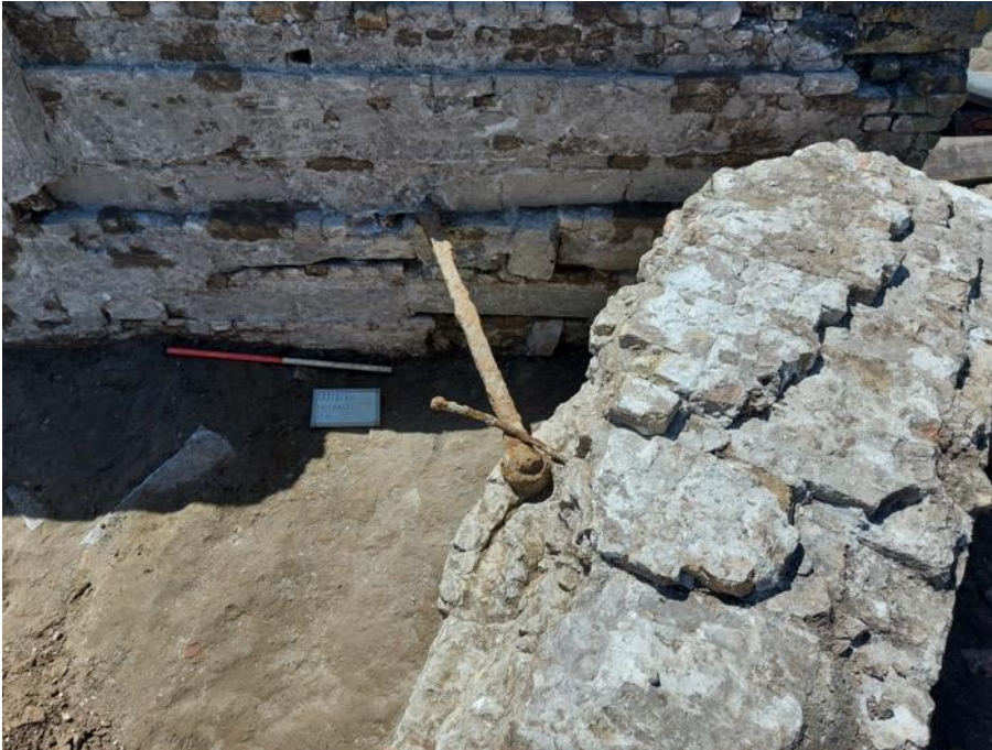
Figuur 24: Detailfoto van anker S10, met metalen trekker ingewerkt in de zijmuur S1. Zicht naar de zuidwestelijke kopmuur S12 (Foto: Monument Vandekerckhove nv).
