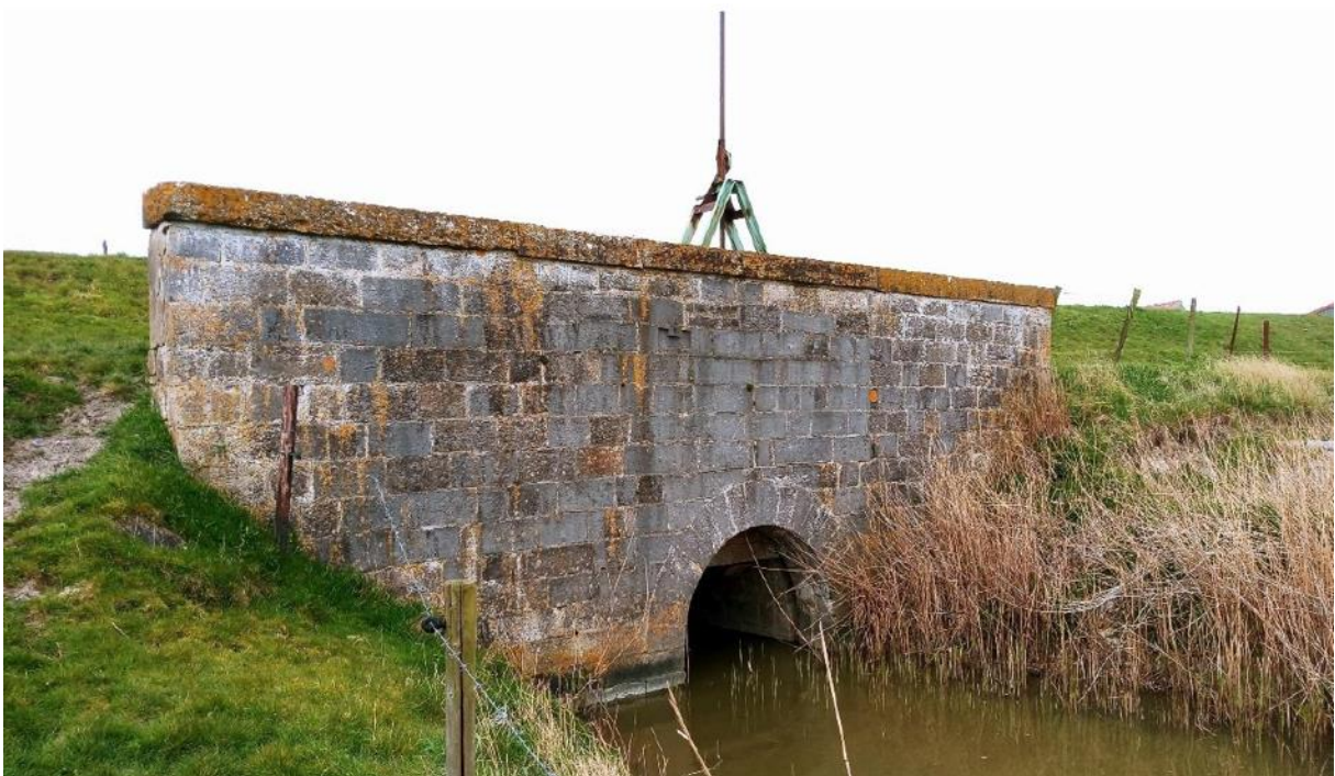
Figuur 3: Zicht op de zuidelijke kopmuur van de Hazegrassluiskop vóór aanvang van de renovatiewerken (Foto: Sofie Vanhoutte).
