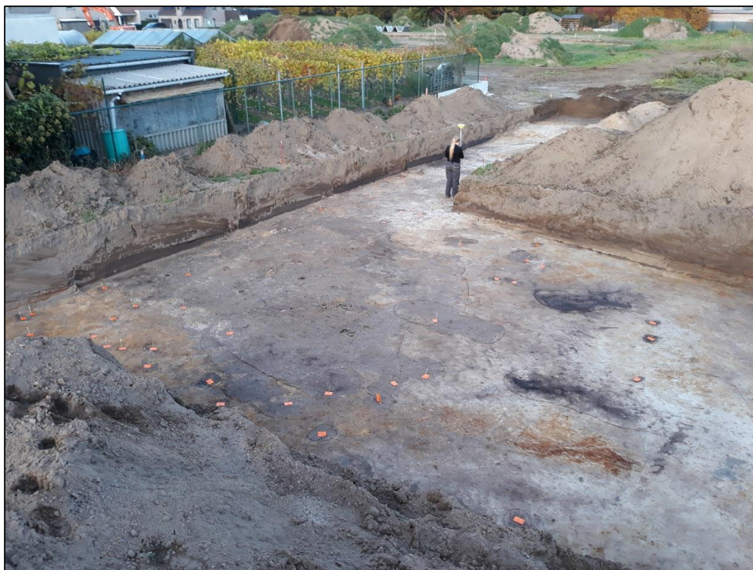
Figuur 7: Inmeten van de sporen ter hoogte van werkput 2 met zicht op buffer tegen tuinen bewoners De Cleenestraat.
