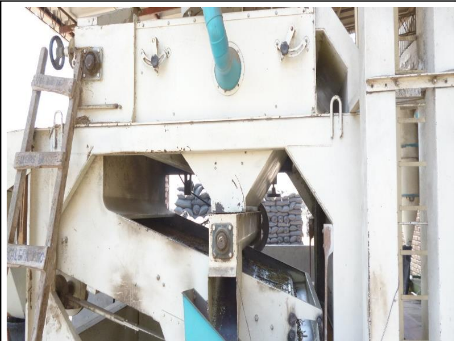
Figura 66. Pre limpia Fuente: Elaboración propia
