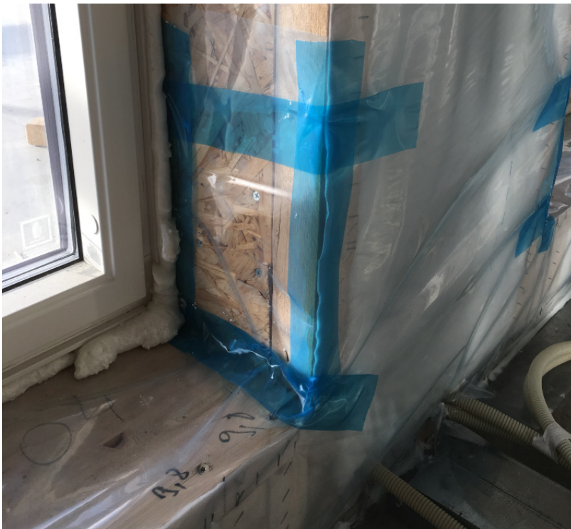
Figur 4.4. Tetning rundt innvendig side av vindu, hvor dampsperra er brettet inn bak vinduskarmen. Her er det forsøkt å teipe dampsperskjøten i det innvendige hjørnet med en ekstra innlagt dampperreflik. Vi ser at det har dannet seg luftlommer mellom teip og dampsperra som neppe er lufttette. Selve monteringsfugen er skummet (mellom karm og dampsperra). Foto: Stig Geving
