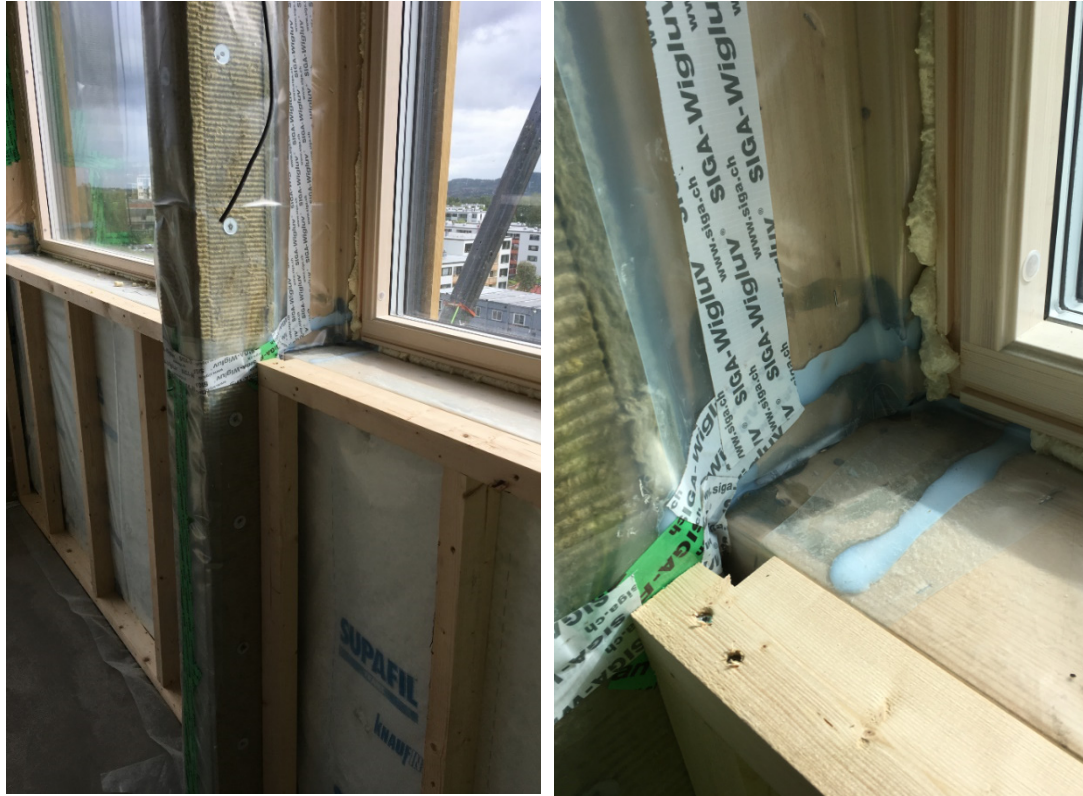
Figur 4.3. Tetning rundt innvendig side av vindu, hvor dampsperra er brettet inn bak vinduskarmen. Her er teip benyttet for å tette de "enkler" dampsperskjøtene, mens de kompliserte brettingene i hjørnet er tettet med lim og selve monteringsfugen er skummet (mellom karm og dampsperra). Generelt mener vi det er fordelaktig å bruke færre tetteløsninger. Bruk av skum vanskeliggjør senere justering av vinduer. Foto: Stig Geving
