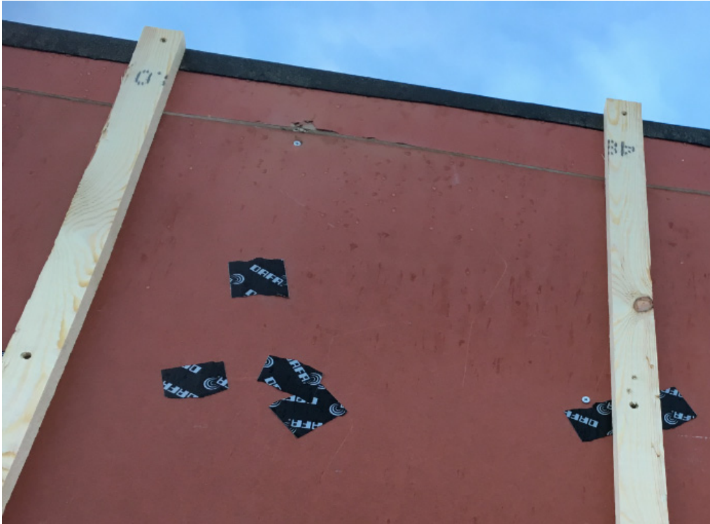
Figur 4.10. Teip benyttet til reparasjoner av skader/sår i vindsperreplata. Teiping av skjøt i topp er av- glemt. Foto: Stig Geving
