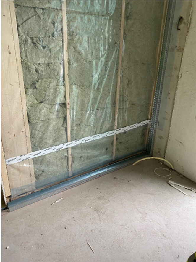
Figur 4.12. Teipet skjøt i dampsperre på innvendig side av yttervegg. Det er benyttet en vindsperreteip som er beregnet for utvendig bruk. Det er usikkert hvordan heften mot PE-folien vil utvikle seg på sikt. Kilde: Øksnevad & Nerdal (2021).
