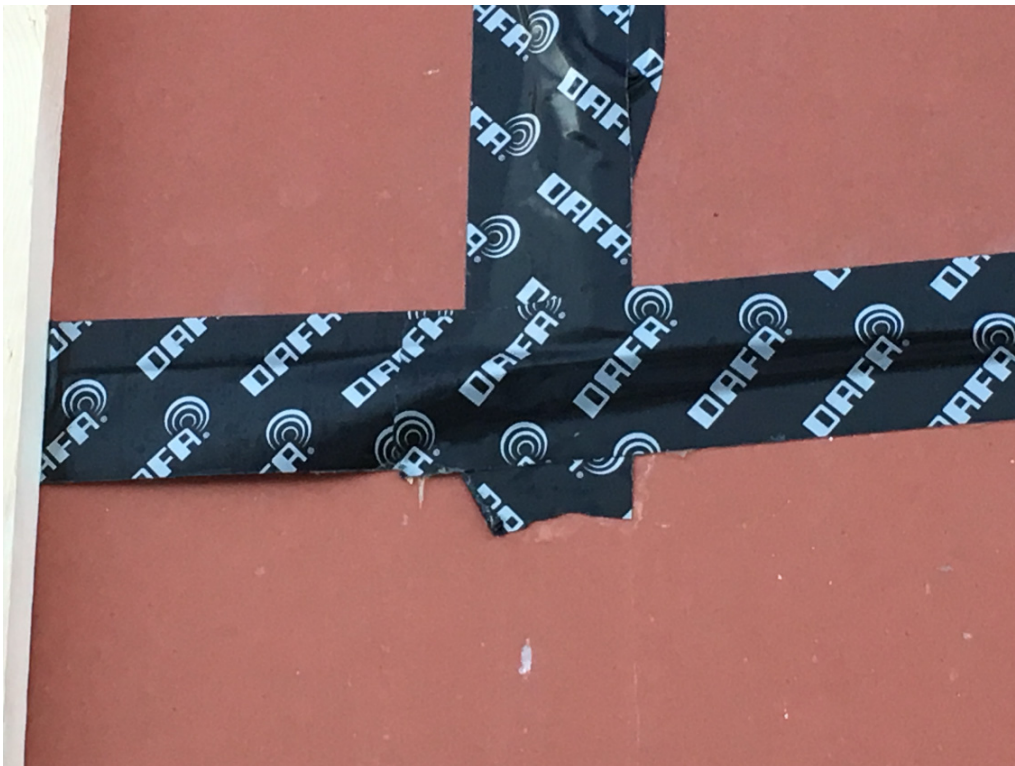
Figur 4.11. Tetning i skjøter mellom utvendige gipsplater. Vi ser at teipen har løsnet flere steder, trolig som følge av fuktig underlag, lav temperatur e.l. Foto: Stig Geving
