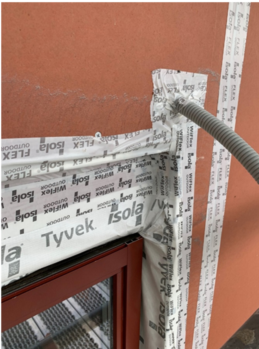
Figur 4.1. Utvendig teiping rundt vindu, gjennomføring av kabelrør og i skjøten mellom to vindsperrplater. Det er lagt vindsperrereduk mot vinduet som er teipet mot vindsperrplate. Det er utfordrende å tette i hjørnene. Det er mye overlapping og ujevn overflate som fører til luftlommer. Det er teipet på et unormalt stort område som vil redusere uttørkingen dersom dampmotstanden til teipen er stor. Kilde: Øksnevad & Nerdal (2021).
