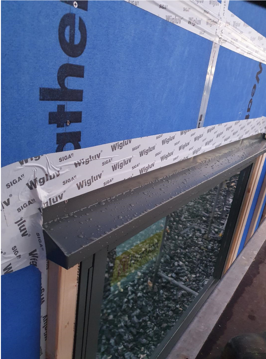
Figur 4.14. Teiping mot beslag i overkant av vindu. Hjørnene, som flere ganger er trukket fram som utfordrende detaljer, er utført med overlappende teip, og man kan se at det har oppstått luftlommer. Her har imidlertid ikke teipen mot beslaget en lufttettende funksjon, men skal hindre inntrenging av regnvann. Luftlommene er således uproblematisk her. Kilde: Øksnevad & Nerdal (2021).
