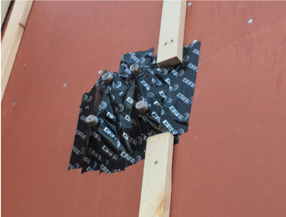
Figur 4.7. Tetning rundt bolter og festeplate for en utenpåhengt konstruksjon. Her er det forsøkt tettet etter beste evne, men det har oppstått mange luftlommer mellom hver enkelt teipbit. I tillegg er det benyttet vel korte teipbiter som gir lite festeareal mot vindsperra. Videre er det uklart hvor vanntett teipingen er i forhold til regnpåkjønning i byggefasen og senere. Foto: Stig Geving
