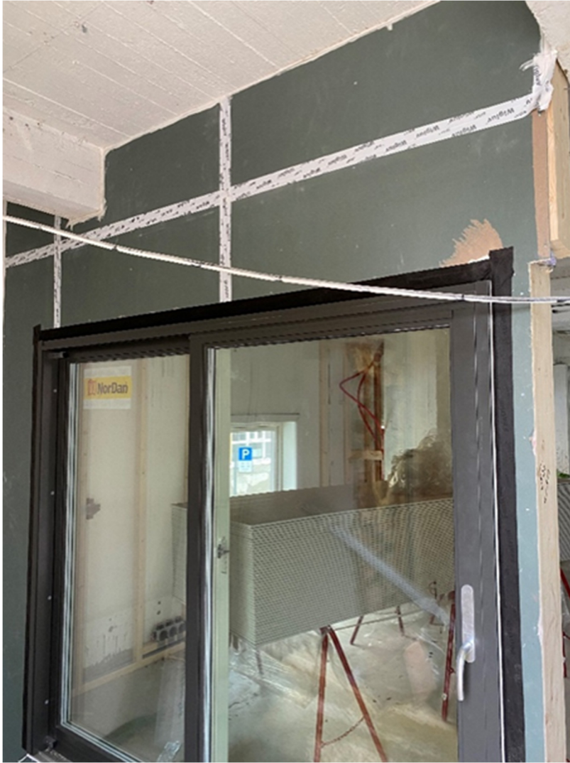
Figur 4.9. Teiping av vindspærreskjøter og teiping rundt ytterdør til balkong. Den hvite teipen som er brukt i vindspærreskjøtene, er en vindspærreteip, mens den svarte teipen rundt døra er en UV-bestendig teip. Kilde: Øksnevad & Nerdal (2021)
