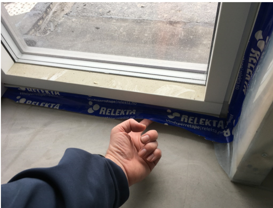
Figur 4.13. Teip mot betongdekke/avretningsmasse har løsnet. Avretningsmassen var ikke primet på forhånd. Her ser vi for øvrig en variant av tetning rundt vindu hvor dampsperra er teipet mot vinduskarmen slik at man unngår separat tetting av monteringsfugen med fugeskum eller fugemasse. Utfordringen er da at det kun er den lille "leppa" på utsiden av sporet til fôringen man kan teipe mot, noe som gjør metoden følsom for utførelsesfeil. Foto: Stig Geving
