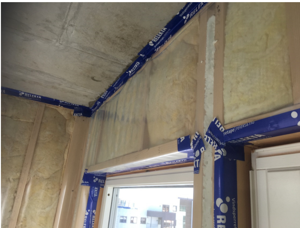
Figur 4.6. Tetning rundt innvendig side av vindu, hvor dampsperra er brettet inn i utsparingen, men ikke helt inn bak vinduskarmen. Dampsperra er deretter teipet inn mot stender/losholt, det vil si at teipen ikke er ført helt inn bak vinduskarm. Det er teipet mot betongdekke i tak, som er primet på forhånd. Selve monteringsfugen er skummet (mellom karm og dampsperre). Teipen er en vindsperreteip som av leverandøren oppgis å også kunne brukes for dampsperrer. Det er verdt å nevne at produktet har en SINTEF Teknisk Godkjenning som kun gjelder for vindsperre, og at hverken den tekniske godkjenningen eller leverandørens hjemmeside sier noe om heftegenskaper mot betong. Foto: Stig Geving
