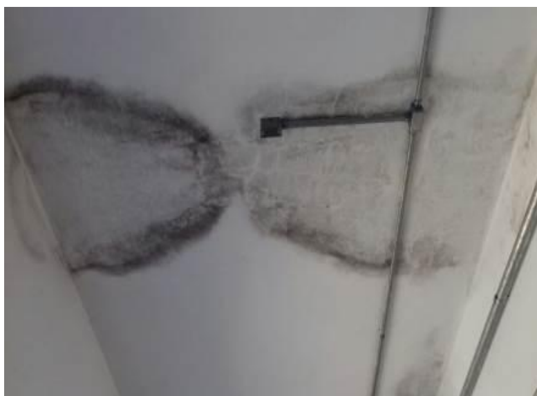
Figura 1. Manchas de infiltração de água da chuva no teto da escola
