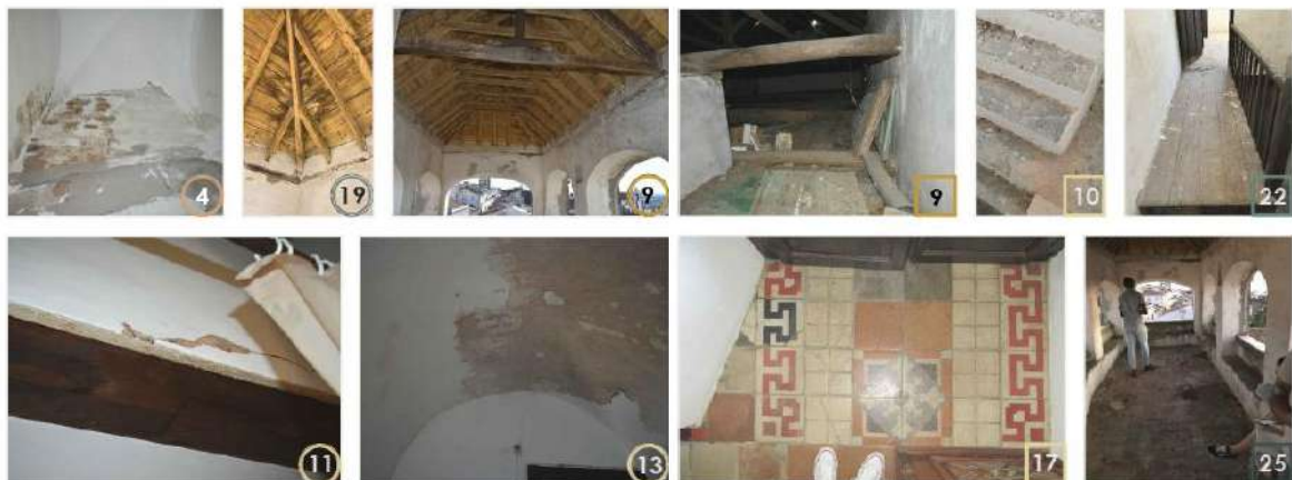
Fig.130: Conjunto de imagens das patologias interiores e exteriores
