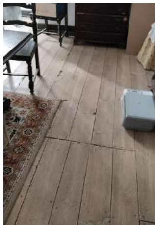
Fig.17: Piso em soalho de madeira, desprotegido, nos quartos – piso 1
