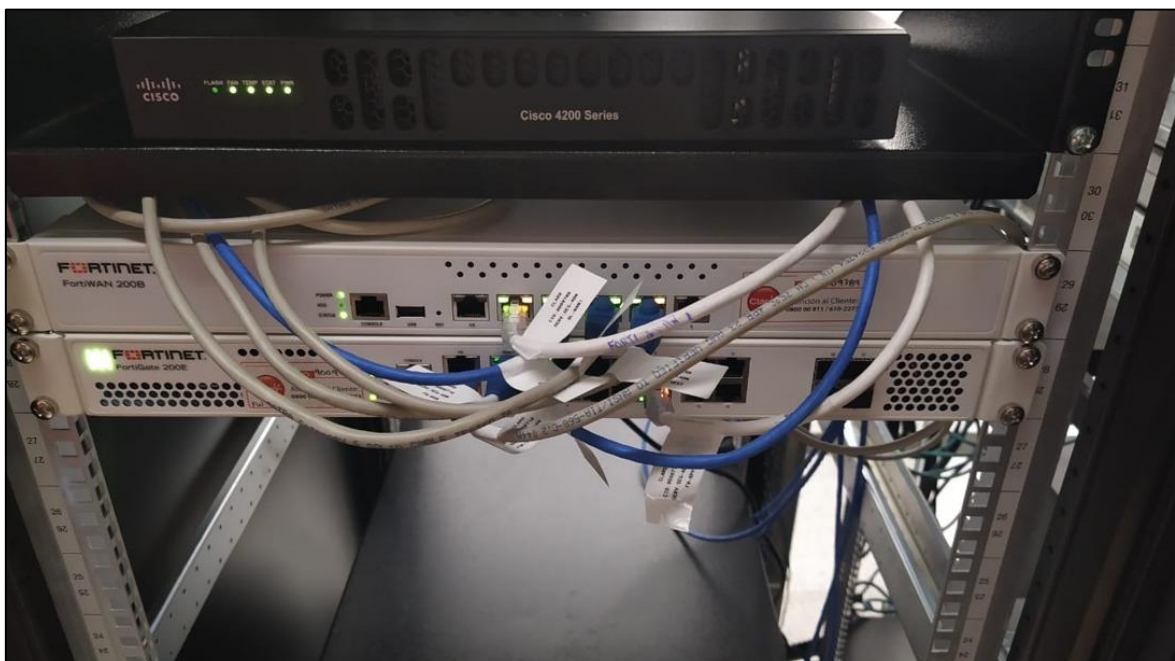
Figura 26: Equipos fortivan 200b y fortigate 200E instalados en sede
