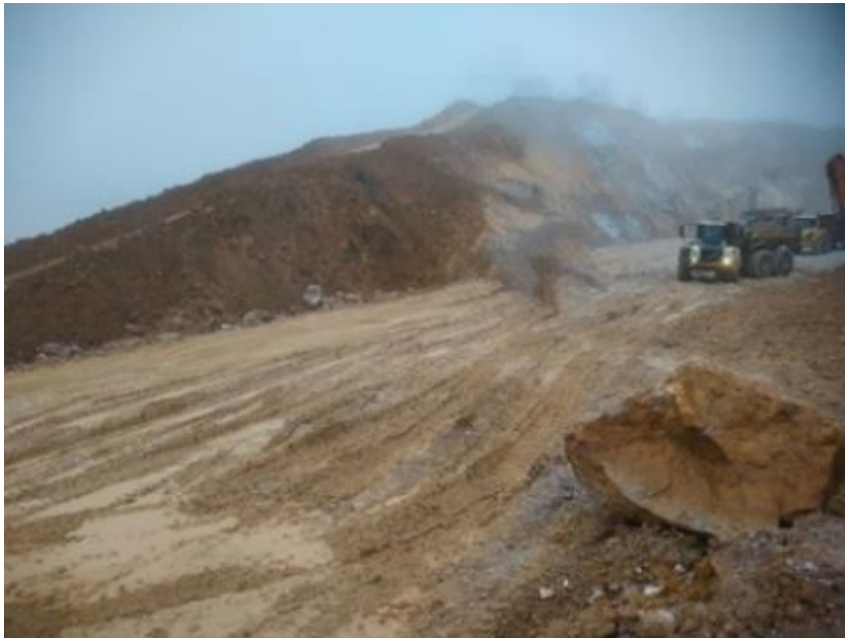
Gambar 3. Kondisi Permukaan Licin Front Loading ( Sumber: Data Primer di Lapangan, 2022 )
