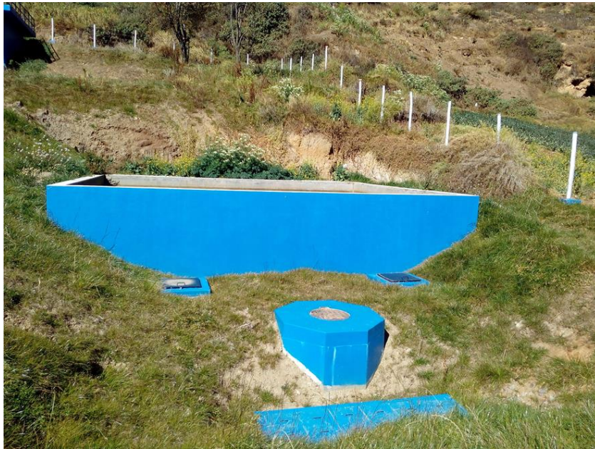
Figura 15 – Cámara de contacto de cloro.
