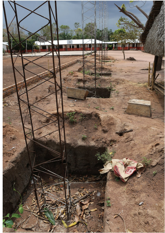
Abb. 4. Fundamentgruben der Pfeiler für ein Dach des neuen Basketballfeldes auf dem Gelände der Schule von Jasiaquiri.
