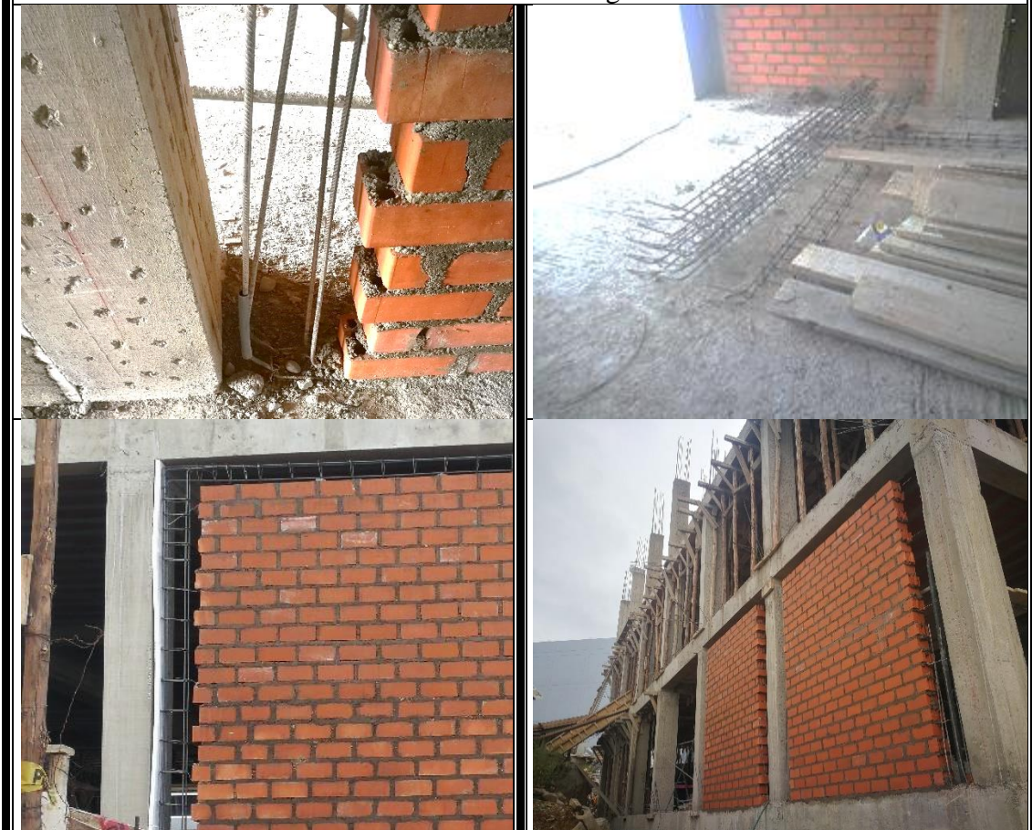
Colocado de Acero en columnas de arrioste y vigas de confinamiento en el segundo nivel
