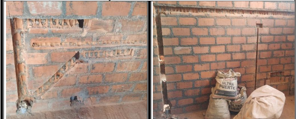
Canalización en los SSH para Instalaciones sanitarias
