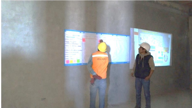
Figura N° 53: En la figura se observa el colocado de los pos'it de del personal de obra de acuerdo a su especialidad.
