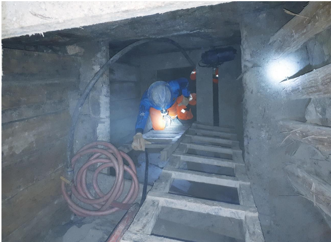
Figura 38: Chimenea 871 del Tajo 858, que presenta vapor de agua.
