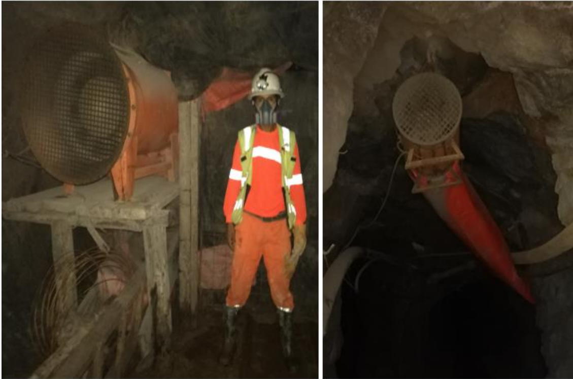
Figura 68: Ventiladores Joy-S-1000: CX 545 – Circuito 1 y 2.
