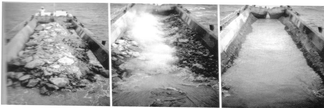
Foto 3. Forma de descarga da barcaça, os matacões são liberadas pelo fundo do Batelão, que, ao abrir-se, provoca a queda do material.
