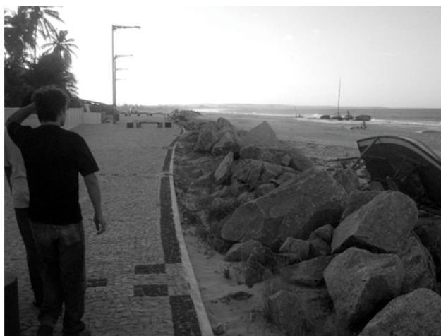
Foto 4. Calçadão da Vila do Pecém com enrocamento feito de blocos de rochas, atualmente soterrado, anteriormente servia de proteção contra a ação das ondas. Fonte-autor.
