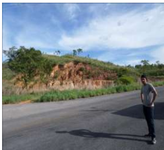
Figura 11 – Feições resultantes dos processos erosivos na entrada do balneário Azuis.
