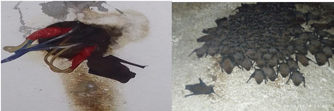
Figura 2. M. Molossus en instalaciones eléctricas y almacén de materiales de la construcción de la UDG
