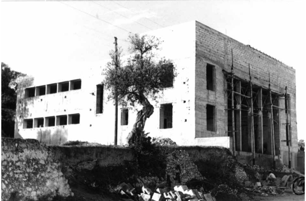
Fig. 1. El edificio del Museo durante las obras de construcción llevadas a cabo en los años sesenta.
