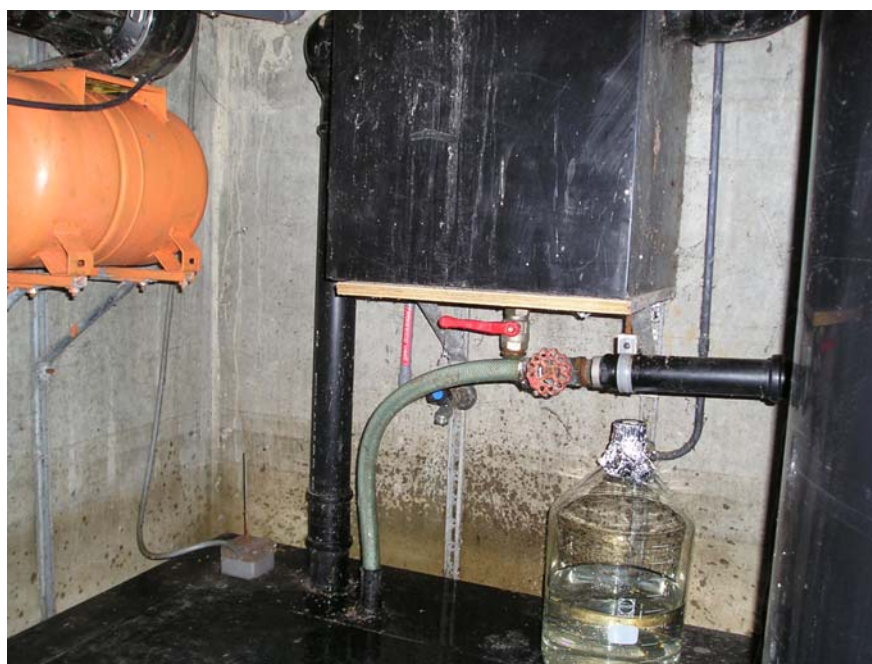
Inpandig opslagreservoir voor opvangen hemelwater
