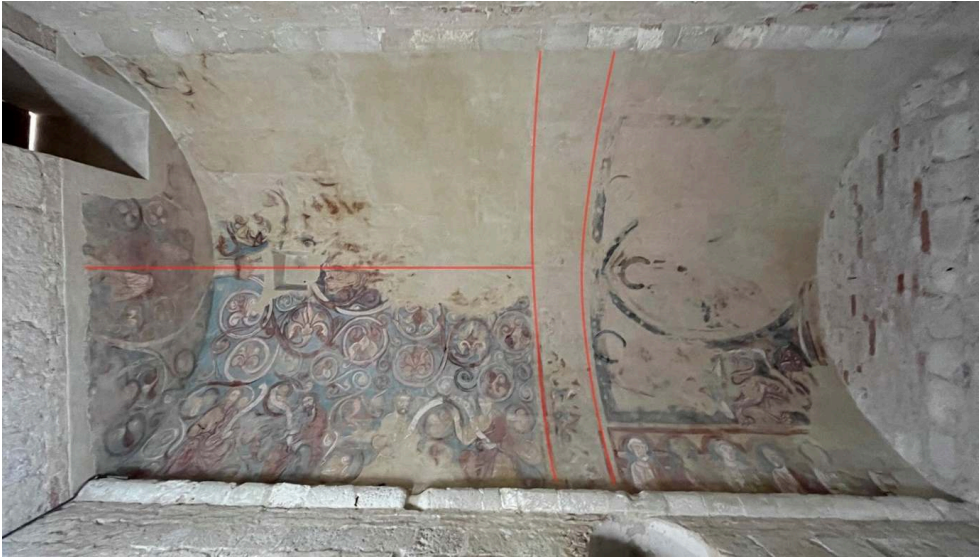
Moissac (Tarn-et-Garonne), chapelle inférieure de l'ancien logis abbatial ; Schéma de l'armature cruciforme en TAU dessinée par le bandeau médian.
