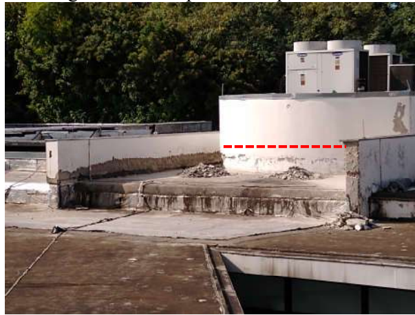
Figura 3 – Exemplo de rodapé fissurado
