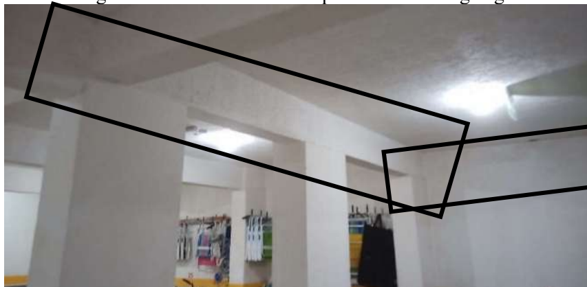
Figura 2 – Manchas causadas pela umidade na garagem
