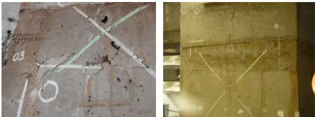
Figura 5: Detalhe da superfície do topo de algum dos pilares analisados.
