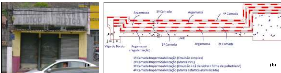
Figura 3 - (a) Marquise deformada pela sobrecarga de painel publicitário [1]; (b) Sobrecarga devido à sobreposição de camadas de impermeabilização [8].
