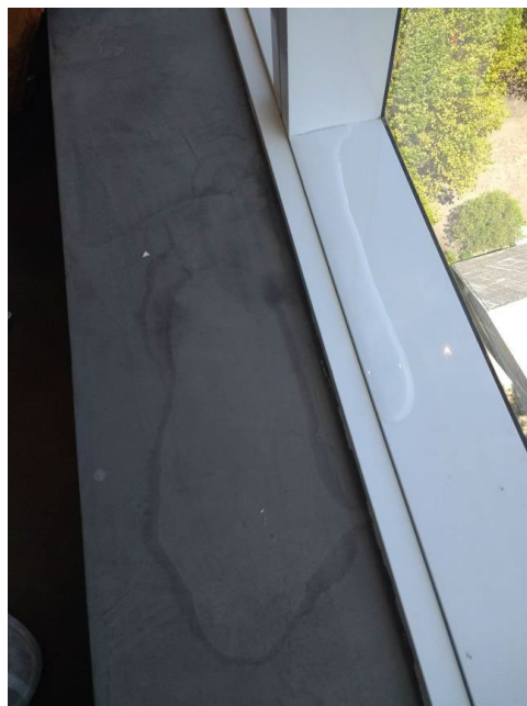
Figura 7: Mancha de infiltração da esquadria
