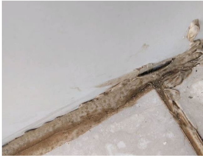
Figura 9: Falha na vedação das placas de ACM
