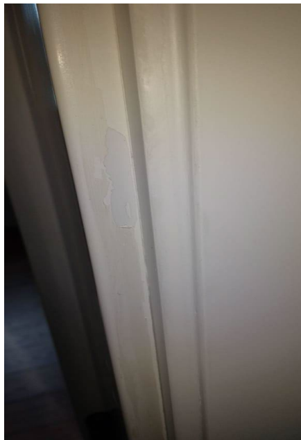
Figura 5: Descascamento de pintura em esquadrias de madeira
