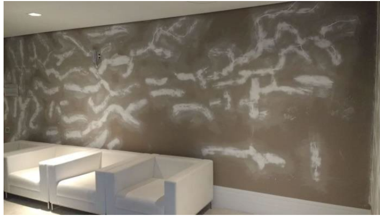
Figura 5: Caso analisado de fissuras em revestimentos de argamassa
