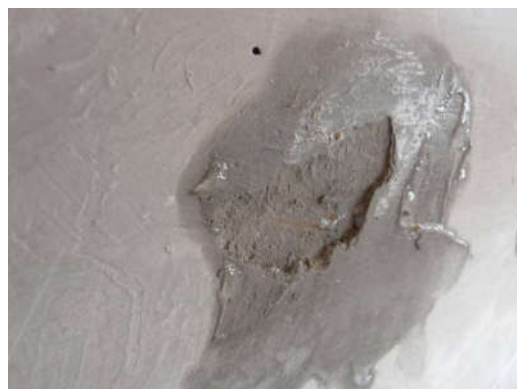
Figura 4 – Detalhe da ruptura do reboco após a medição do tempo de propagação do pulso ultrassônico.
