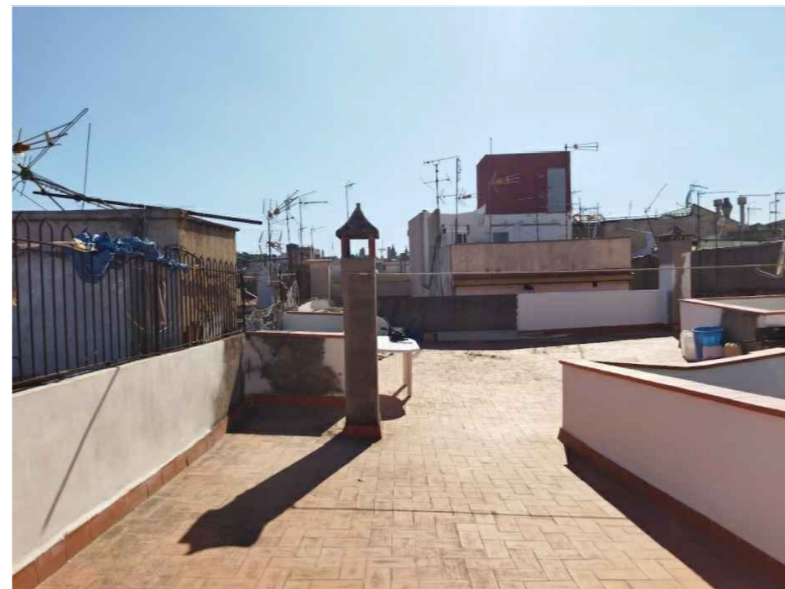
Zona Est de la coberta plana transitable amb paviment de tova ceràmica. Imatge direcció carrer Carretes.
