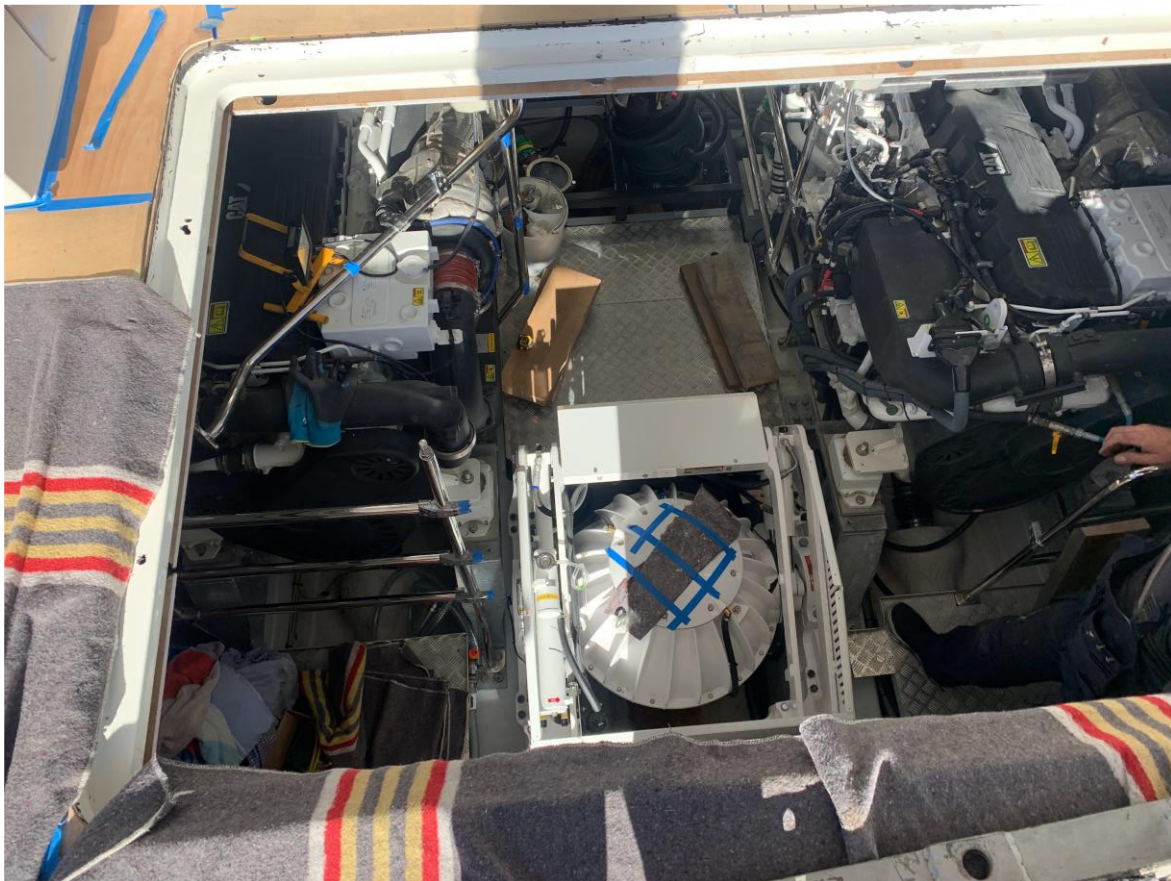
Figura 51: Seakeeper col·locat a la sala de màquines
