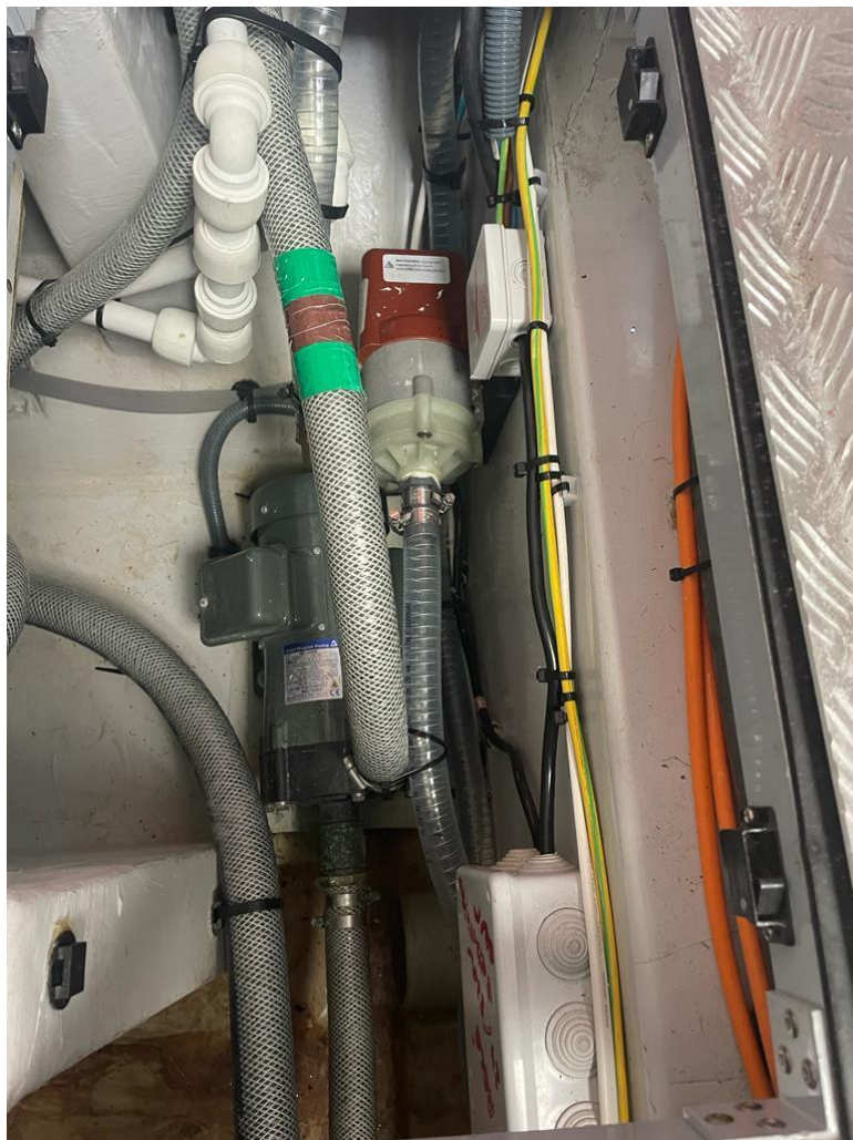
Figura 43: Bomba d'aigua PML500C instal·lada Font: pròpia
