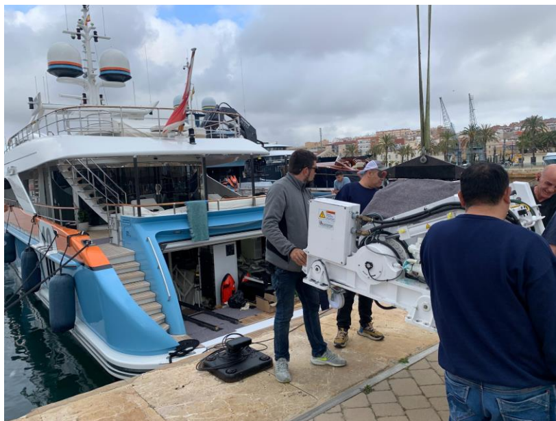
Figura 11: Hessen 37 "Aurelia" amb dos Seakeepers 26 instal·lats
