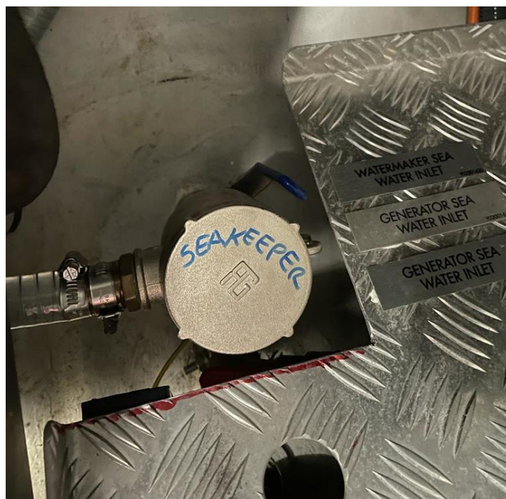
Figura 45: Filtre d'entrada d'aigua de mar amb vàlvula del Seakeeper
