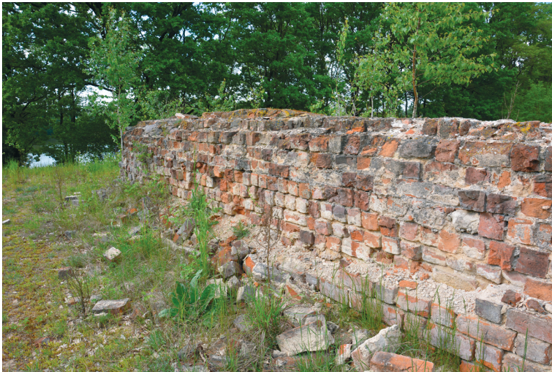
Ryc. 9. Danabórz, pow. wągrowiecki, woj. wielkopolskie. Mur nieukończonej budowli sakralnej (fot. A. Różański)
