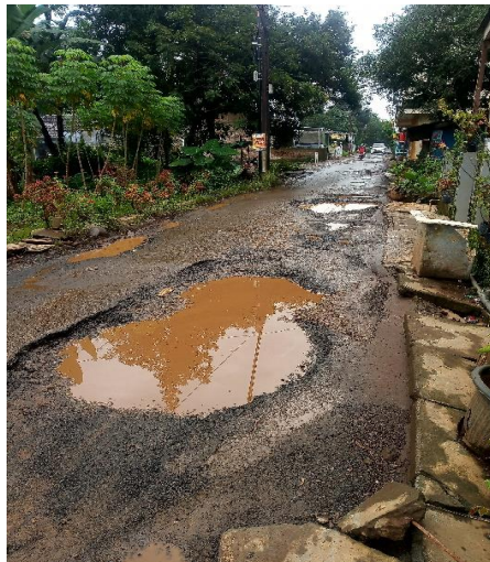
Gambar 4. 1 Kondisi Jalan Utama Kampung Bandungsari RT 01
