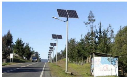
Figura 13. Alumbrado público solar
