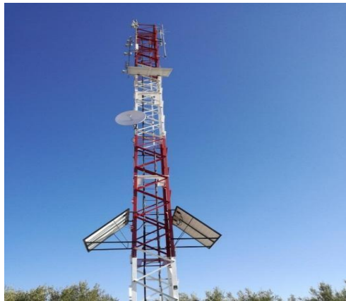
Figura 11. Sistemas solares para telecomunicaciones
