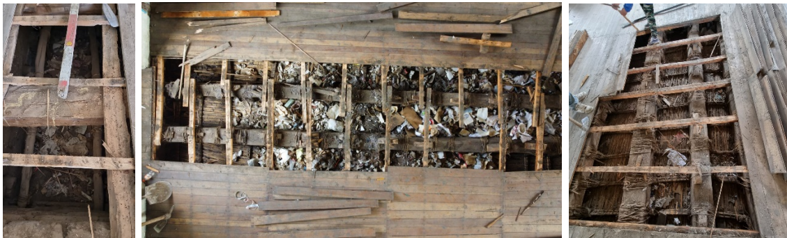
Ilustración 1 Estado actual de la viga de entrepiso
