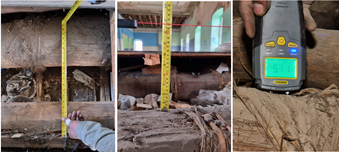
Fotografía 1. En el entrepiso de madera del bloque C tiene una humedad en la base 6%, en humedad intermedio de 13.4%.
