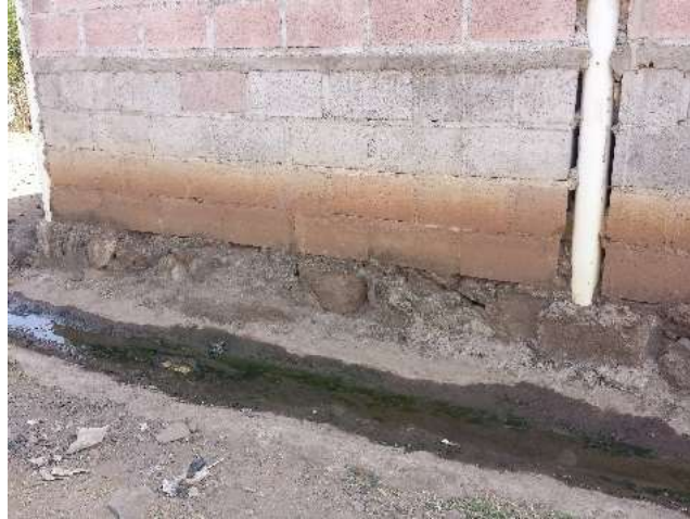
Figura 2.5 Huella de agua debido a desbordamientos por aguas lluvia prolongada. (Altura de nivel de suelo 70cm), ubicada en Caserío San Pablo. Fuente propia (Fotografía tomada en abril de 2017).
