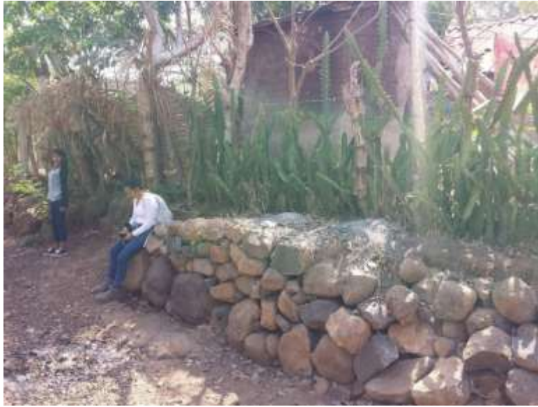
Figura 4.7 Bordas artesanales usadas como protección en época de lluvia para mitigar el impacto de las aguas contra las viviendas. Fuente propia (Fotografía tomada en mayo de 2017).
