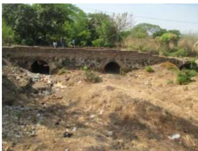
Figura 5.8 Esta figura muestra la reducción del paso de agua por el Caserío Puente Roto, situación que genera el aumento del nivel del agua. Fuente propia (Fotografía tomada en mayo de 2017).
