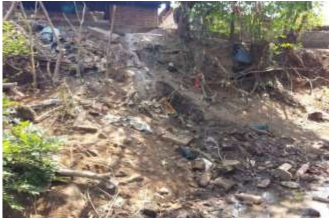
Figura 5.10 Vivienda sin borda muestra erosión en el talud, situación que a pesar del material de la vivienda representa un riesgo. Fuente propia (Fotografía tomada en mayo de 2017).
