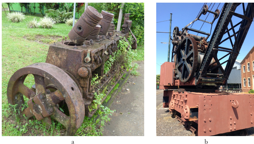
Figura 6.13. a) Estructura metálica que presenta corrosión severa (izquierda). b) Estructura metálica protegida contra la corrosión con pinturas anticorrosivas (color rojo). Nótese que en las zonas en las que no hay pintura anticorrosiva la corrosión es más severa
