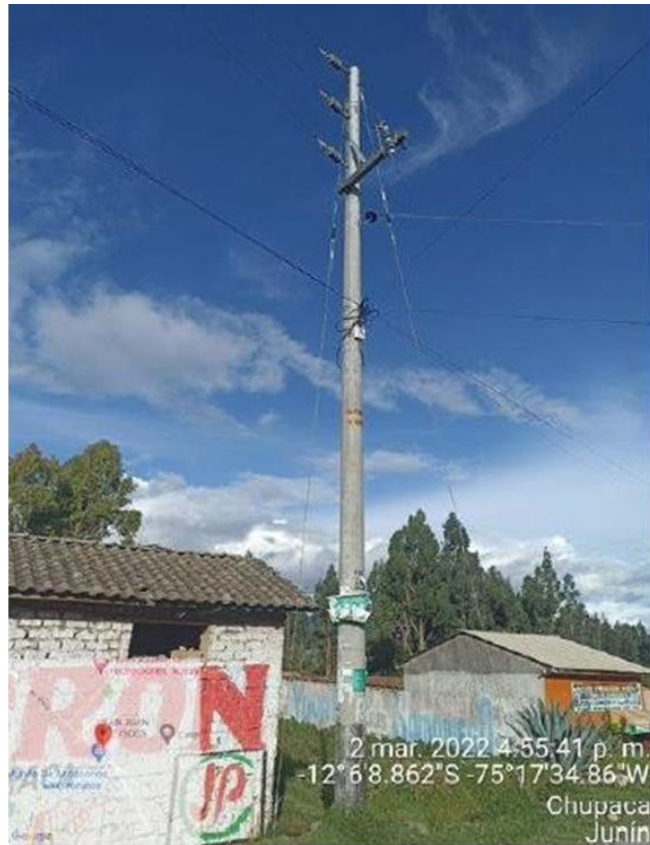
Figura 4. Registro fotográfico del alimentador A4402 – seccionador monopolar SEC1_IPH antes
