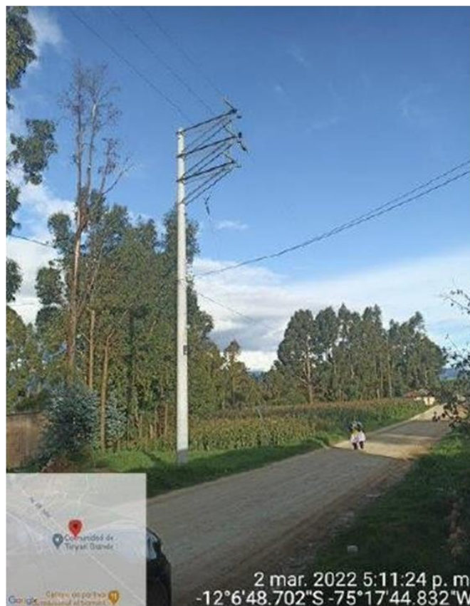
Figura 5. Registro fotográfico del alimentador A4402 – seccionador monopolar SEC2_IPHA antes
