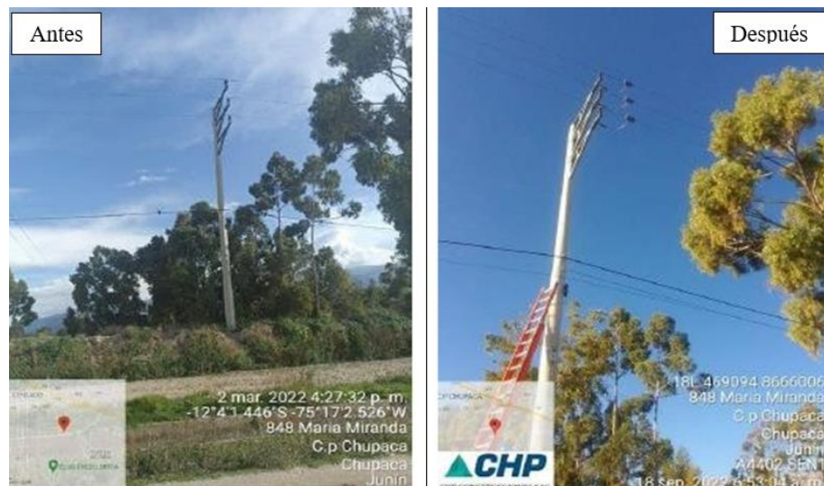
Figura 31. Comparativa antes y después de la instalación de la comunicación inteligente SEN 1
