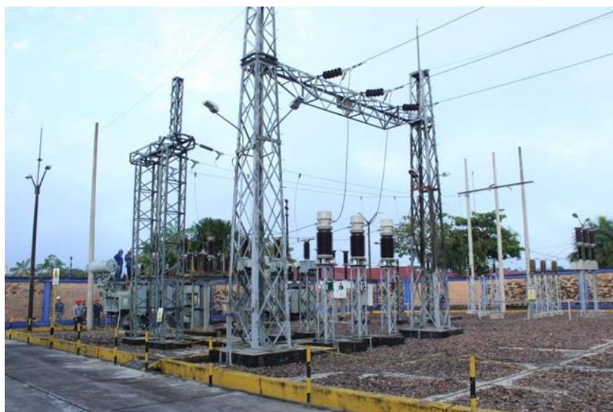
Figura 10. Patio de llaves de una subestación clásica
