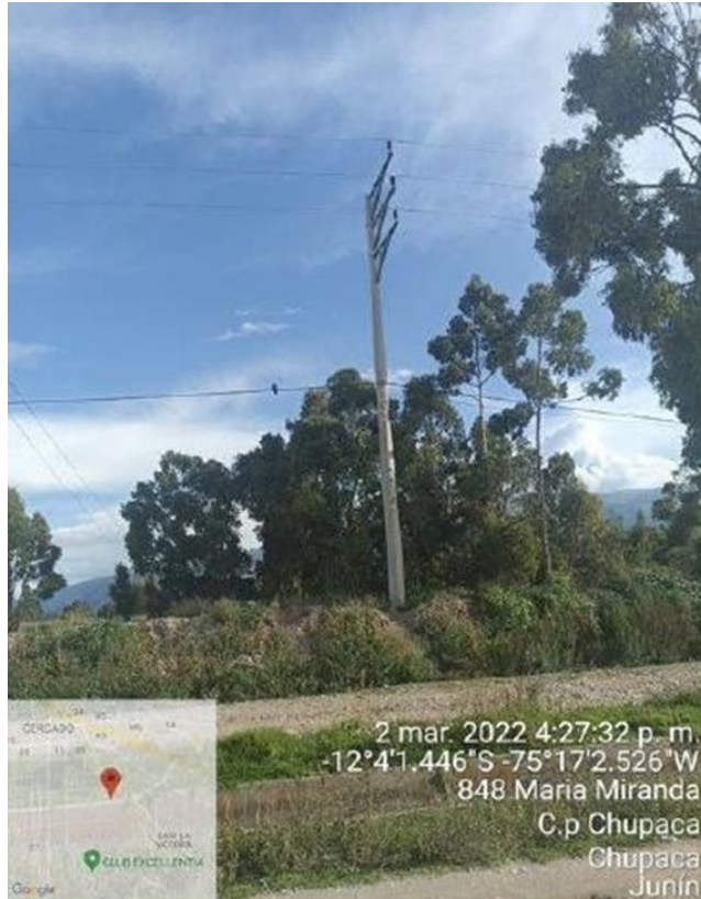
Figura 6. Registro fotográfico del alimentador A4402 – sensor inteligente con sistema de comunicación SENI antes
