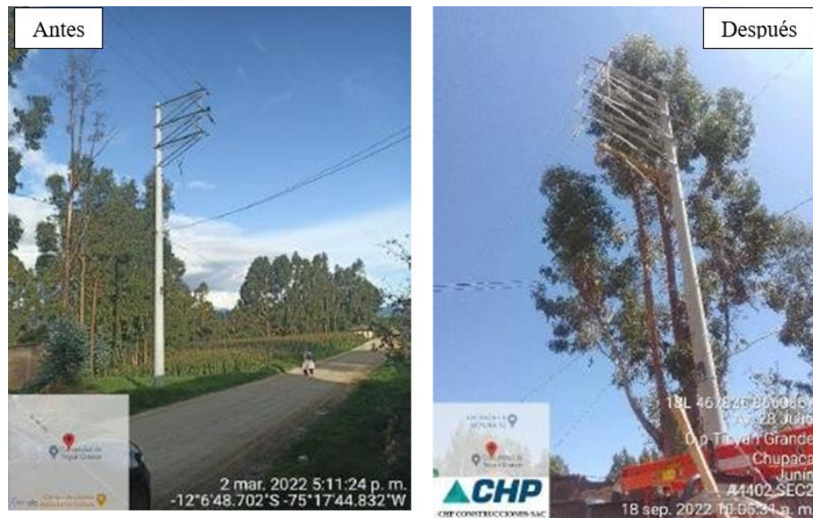
Figura 30. Comparativa antes y después de la instalación del seccionador monopolar SEC2
