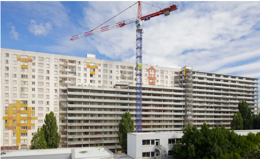
Figura 27. Proceso constructivo mediante modulación e industrialización. 530 viviendas de Grand Parc Elaboración Philippe Ruault. Fuentes: web oficial Lacaton & Vassal
