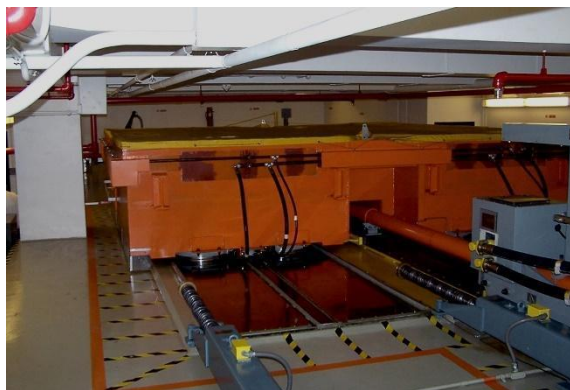
Figura 7: Amortiguador de Masa Sintonizada en John Hancock Tower (LeMessurier, 2019)
