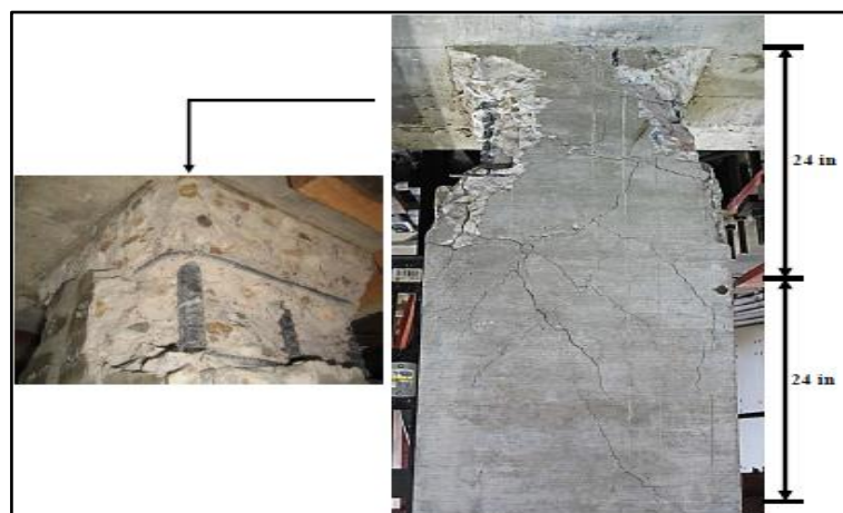
Figura 51: Condición de la bisagra superior de la Columna.
