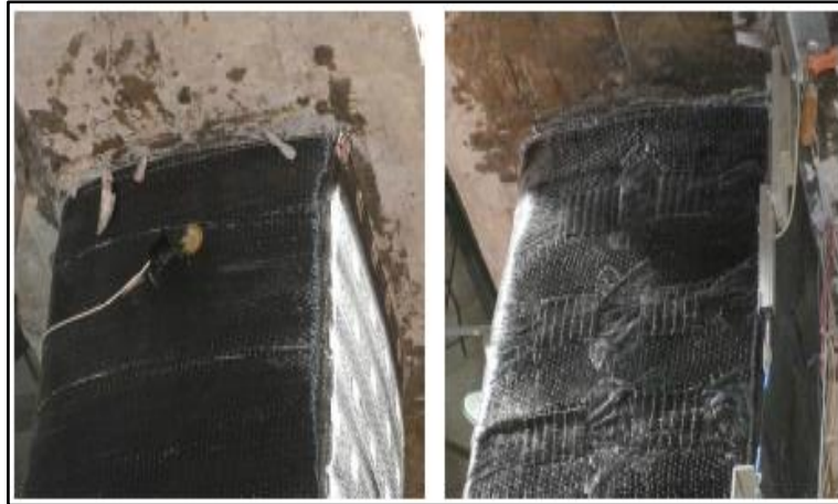
Figura 69: Buen estado de las láminas de CFRP y anclajes después del 9° ciclo histéresis.
