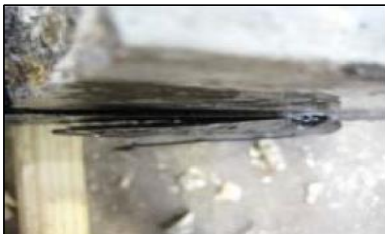
Figura 36: Desunión del ventilador de anclaje debido a epoxy de mala calidad.
