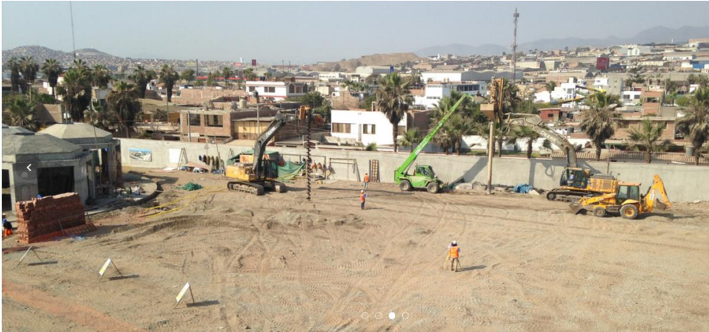
Figura 22. Proceso Constructivo para la instalación de las Pilas de Gravas Compactadas: Perforación helicoidal del terreno natural, Adaptado de " http://www.emin.pe/portfolio/colegio-villa-perse/ ", por EMIN GEOESTRUCTURAS, 2016.
