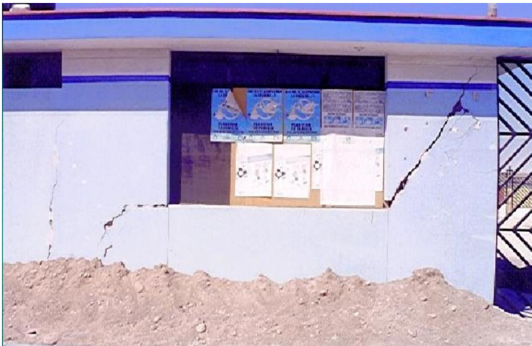
Figura 44. Fallas por expansión de suelos en una vivienda de la ciudad de Iquitos. Adaptado de “Problemas presentados por los suelos a las obras de Ingeniería”, por Aguilar, 2012
