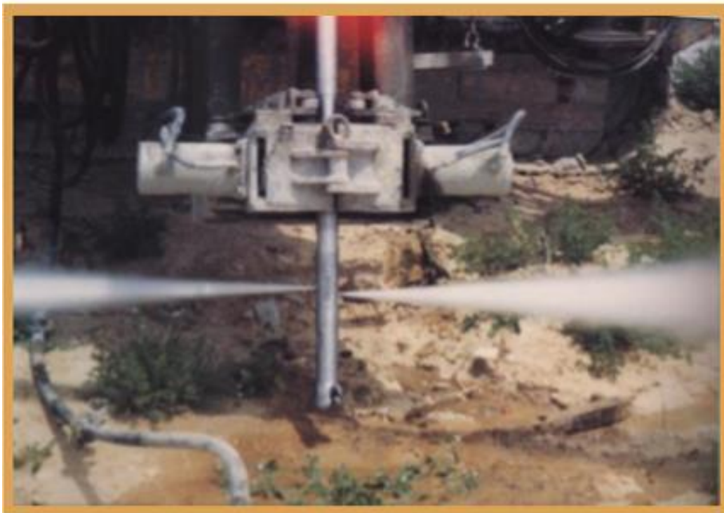
Figura 14. Chorros "jets" de alta velocidad, Adaptado de "Diseño basado en técnicas de fiabilidad del tratamiento de mejora del terreno mediante columnas de grava", por Alonso, 2014
