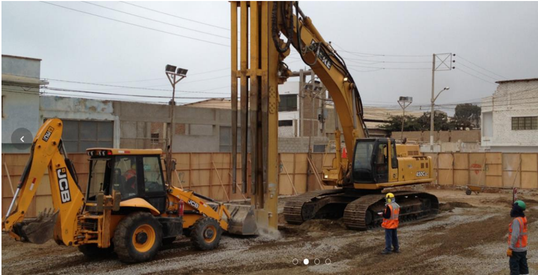
Figura 21. Proceso Constructivo para la instalación de las Pilas de Gravas Compactadas tipo Densipact: Llenado y compactación de agregados en el bulbo y fuste de la Pila., Adaptado de " http://www.emin.pe/portfolio/supermercado-pacasmayo/ ", por EMIN GEOESTRUCTURAS, 2016
