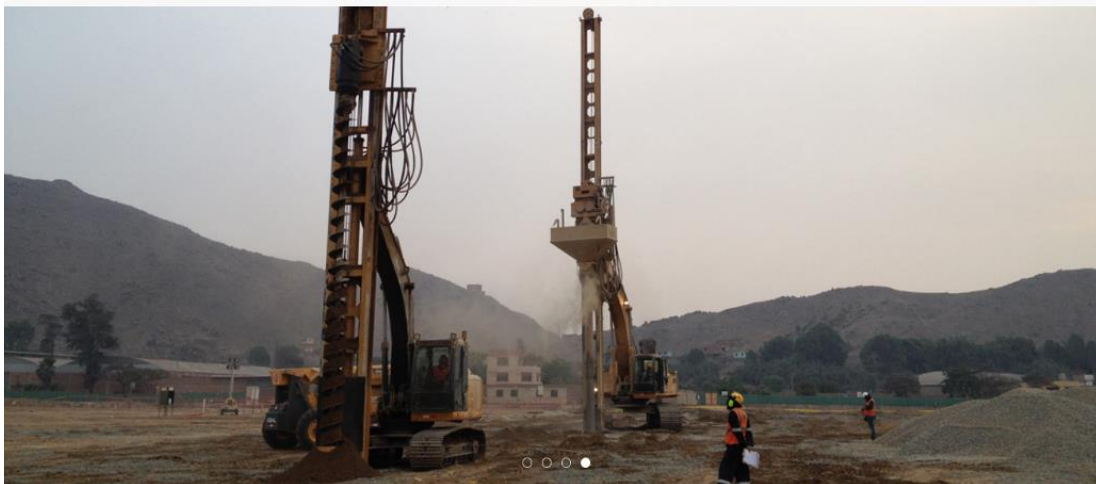
Figura 24. Proceso Constructivo para la instalación de las Pilas de Gravas Compactadas: Perforación helicoidal del terreno natural, Adaptado de " http://www.emin.pe/portfolio/centro-de-distribucion-huachipa-ii/ ", por EMIN GEOESTRUCTURAS 2016)
