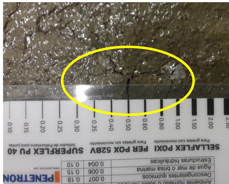
Figura 9 Fisura en concreto patrón de 0.50 mm
