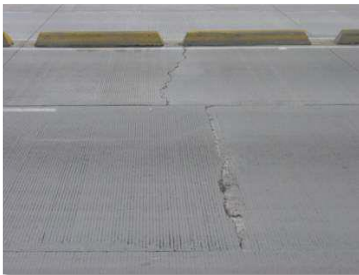
Figura 1 Fisura en concreto
