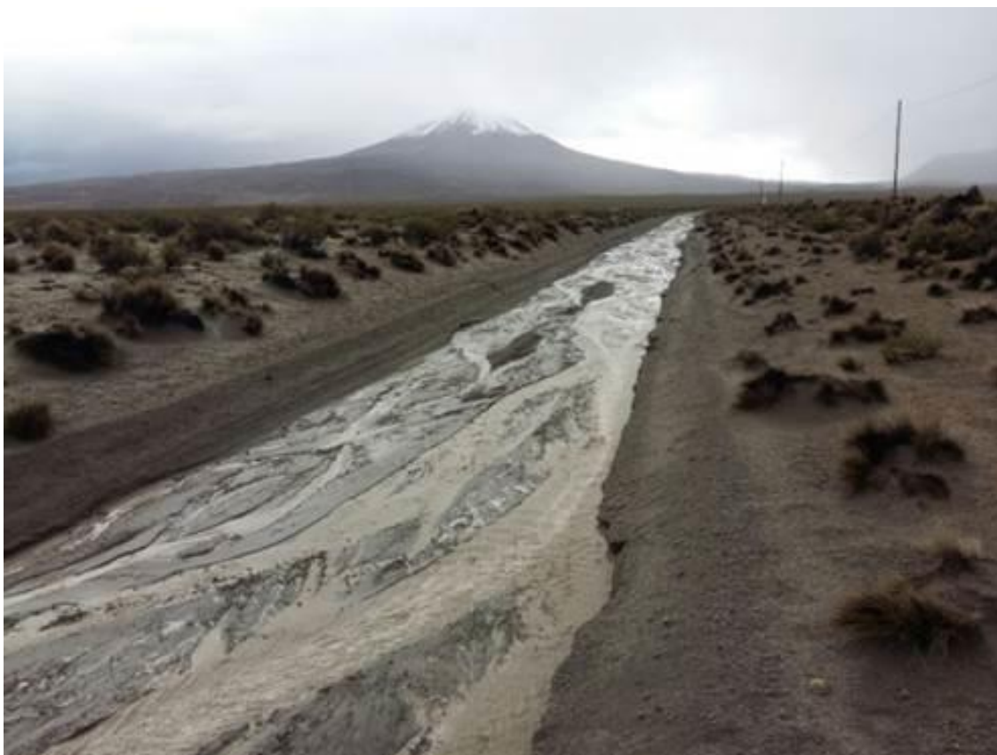
Figura 1. Subrasante arena limosa erosionadas en la carretera Mazocruz-Arequipa, por COSAPI, 2017.
